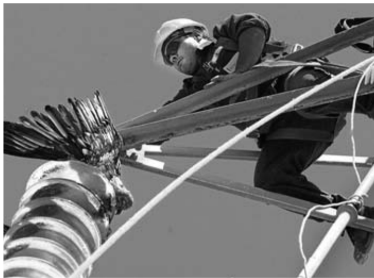
Un operario retira un ave electrocutada en un poste.
